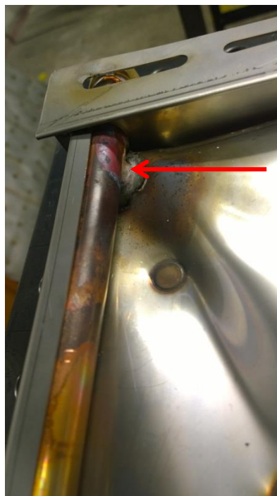
Obr. 4d Detail místa porušení v pájeném spoji
