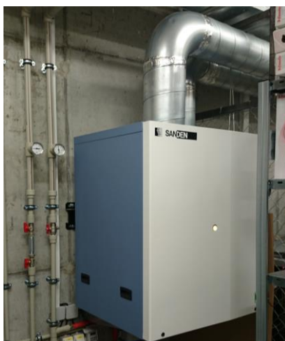
Obr. 1 Tepelné čerpadlo SANDEN Aquaeco 2 odebírající teplo z VZT potrubí.
