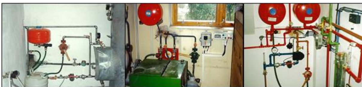
Obr. 7 Běžné ruční dočerpávání kolektorů.
