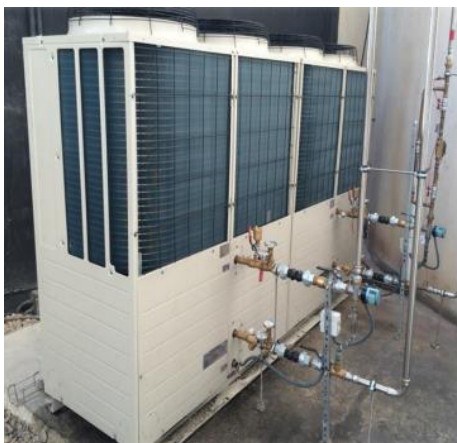
Obr. 2 Tepelná čerpadla MITSUBISHI HEAVY Q ton. Výkon 60 kW.
