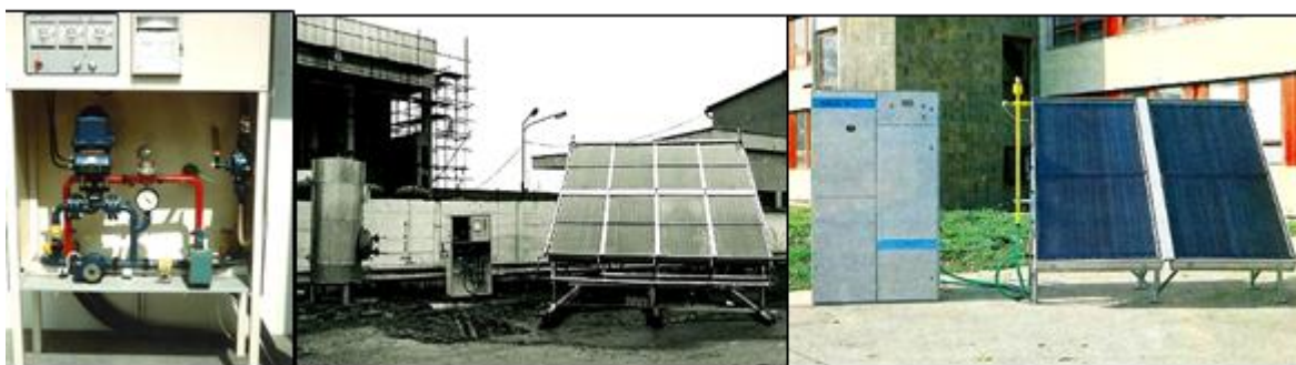
Obr. 8 Dvojitý primární okruh, změna průtoku kolektory a kapotovaná pohonná jednotka. Ukázka typové dodávky solárních soustav. Ve skříni je též solární ohřívač 300 l.
